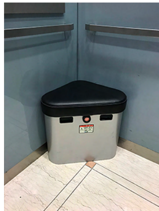
NTビルEV内非常用備品
